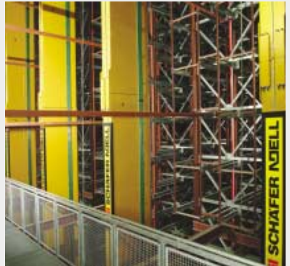
▲ Regalbediengeräte im Hochregallager
