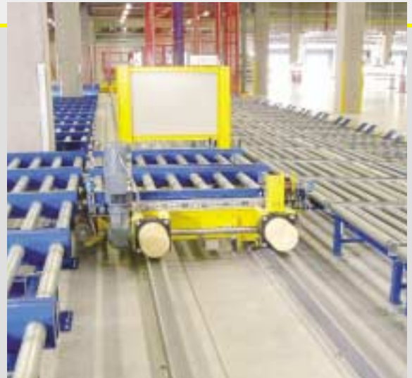
▲ Doppelverschiebewagen in der AAA-Kommissionierung
